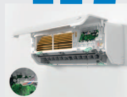
Abrir el cuadro eléctrico y desconecta los motores ventilador y de las lamas
