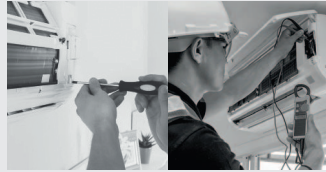
Difícil conexión eléctrica
